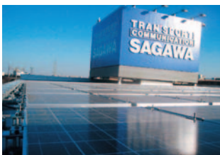
太陽光発電システム
